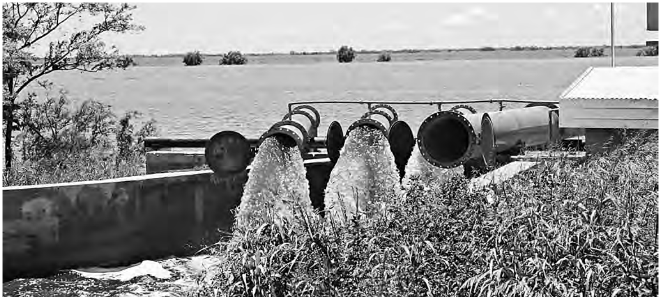
Toma de agua del río San Javier para riego de arroz de la Ea. San Roque en Entre Ríos.
