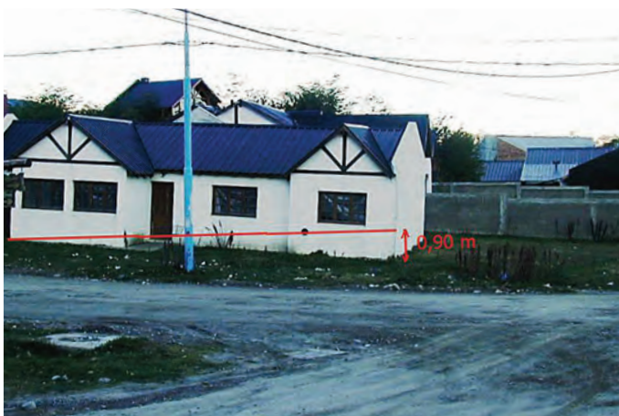
Figura 10.- Subsidencia en el área urbana. En Ushuaia algunas turberas fueron cubiertas con áridos para su urbanización, como el caso que se ilustra. El asentamiento ocurrió luego de la apertura de una zanja para el tendido de servicios que funcionó como vía de drenaje. Este efecto puede ser muy grave en zonas costeras, áreas urbanas y en planicies inundables.
