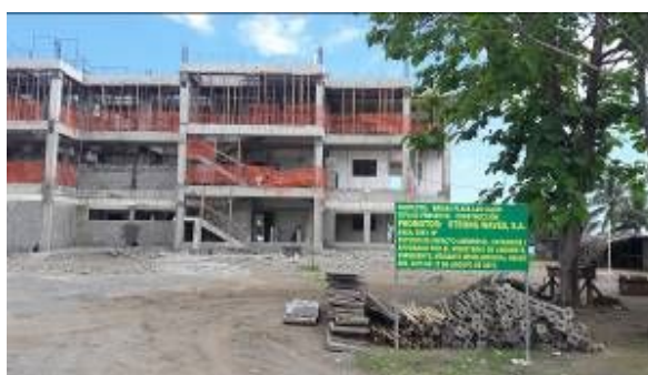
Proyecto turístico en construcción "Brisas Playa Las Lajas", ubicado en la playa Las Lajas, 2016.
