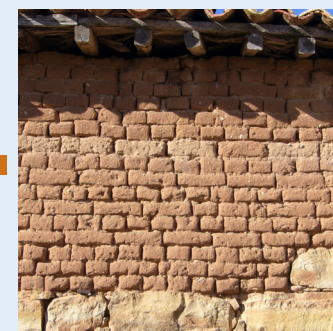
Viviendas construidas con estructuras inadecuadas
