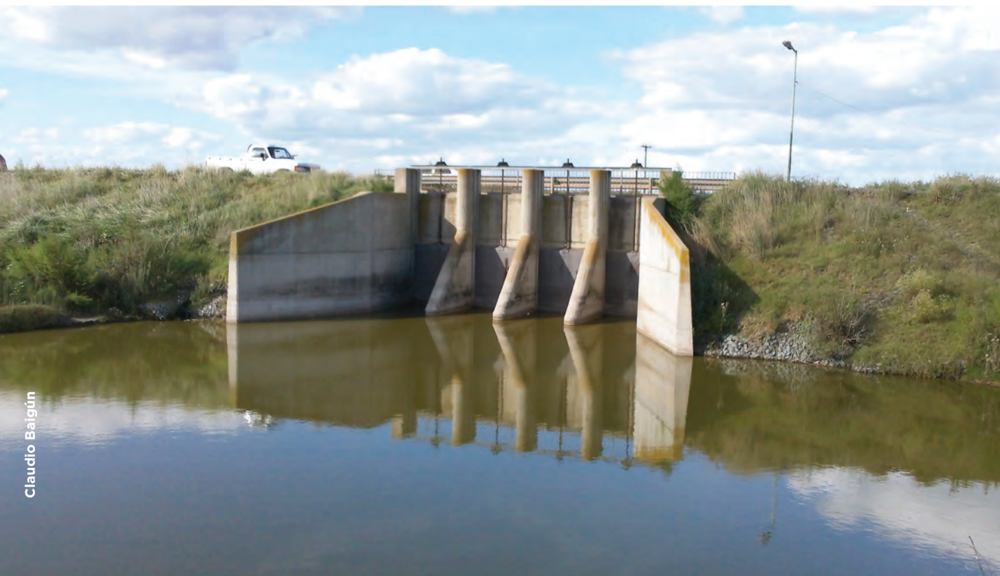
Esclusa instalada en las encadenadas del Salado.
