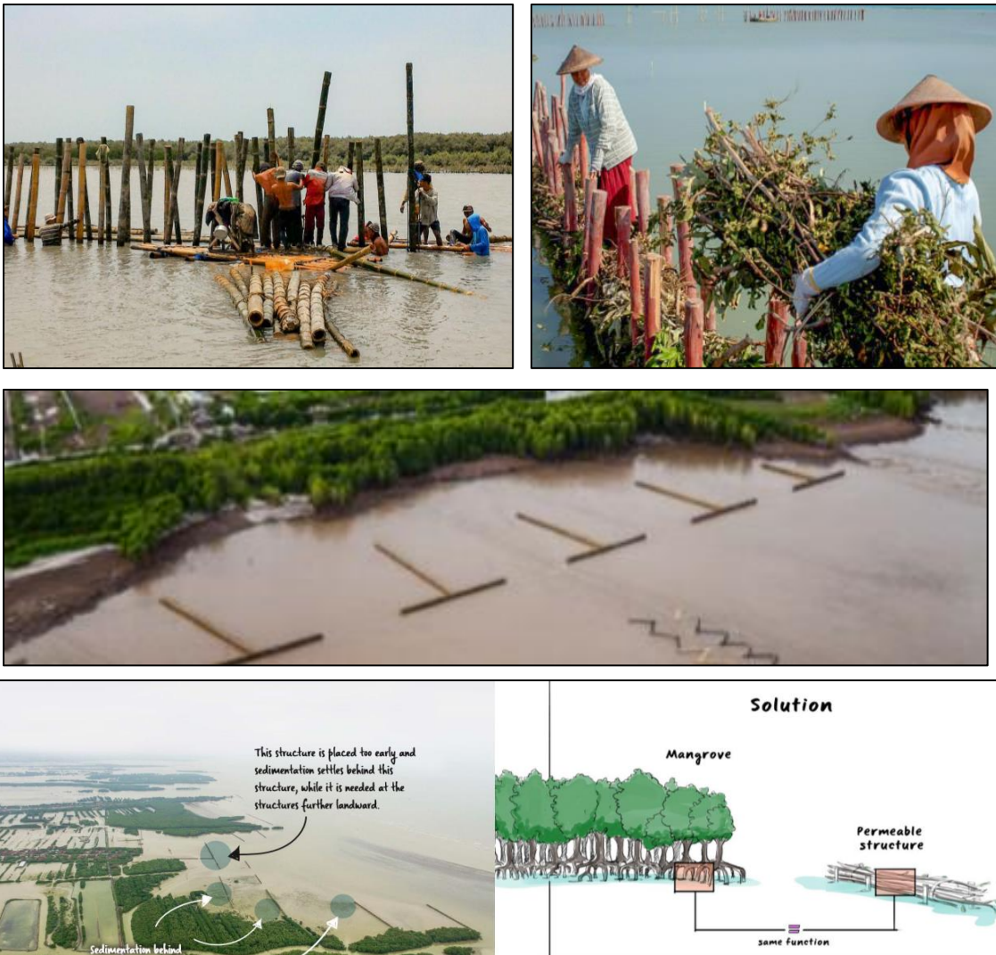
Imagen A1.1. Ejemplo del uso de las barreras permeables para protección costera. Fuente: Building with Nature: Thinking, acting and interacting differently. Ecoshape 2012. Compañía Allied Concrete, Charlottesville, Virginia, EEUU 2018. Wetlands International, 2017.
