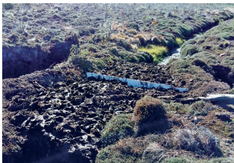
Figura 5.- Cierre finalizado, con nivel de terminación 10 cm por debajo del borde la placa. La compactación de la turba debe alcanzar el fondo firme de la zanja.
