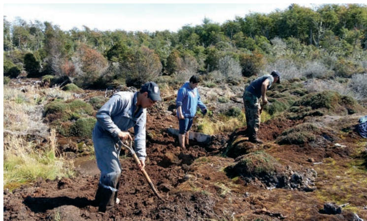
Figura 4.- Tareas de relleno con turba a ambos lados de la placa instalada.
