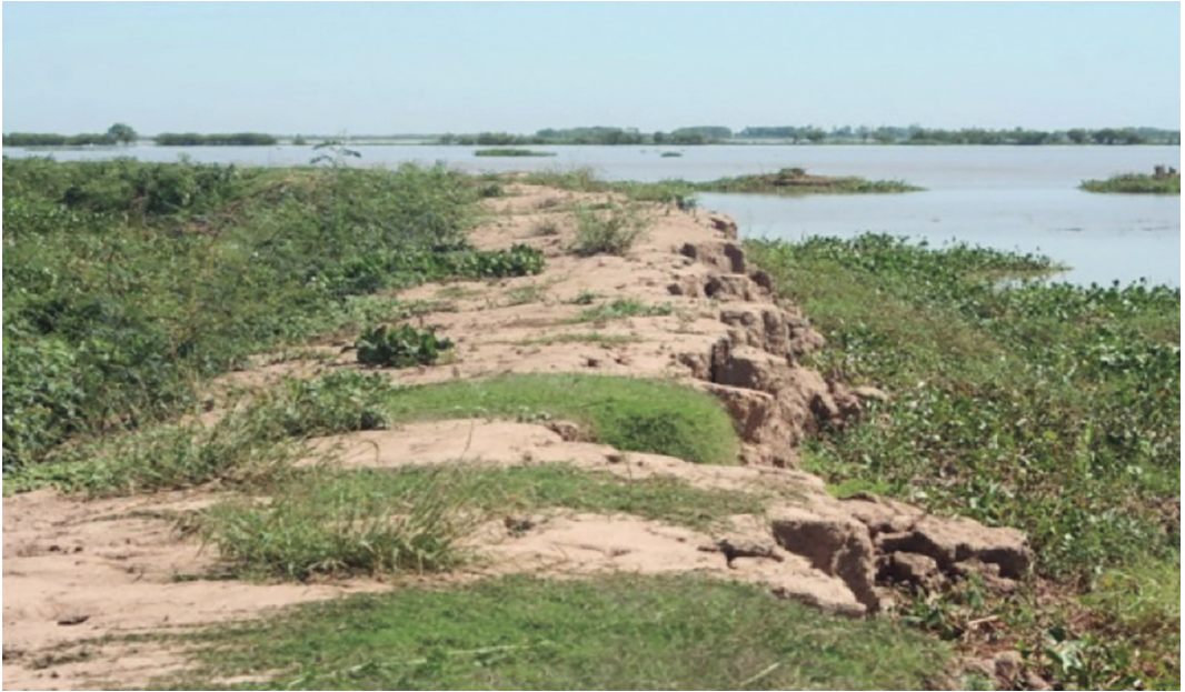
Figura 6.- No debemos potenciar los impactos negativos del Cambio Climático con modalidades inapropiadas tanto en nuestras actividades productivas como en las infraestructuras que, eventualmente, puedan acompañar a estas últimas (Terraplén destruido por una creciente en el centro-S del Dto. Victoria, Entre Ríos; Foto: R. F. Bó)
