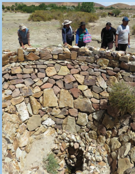
Pozo de agua con empedrado para evitar la erosión, en la comunidad de El Moreno
